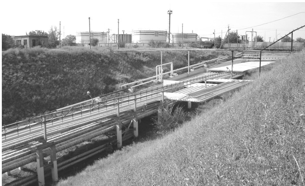
Рис. 3. Эстакадная линия от хранилища к нефтеналивному терминалу
