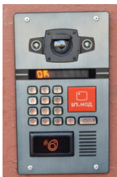
Рис. 3. Камера общего пользования, установленная в вызывную панель входной двери подъезда (основные характеристики: разрешение видеосъемки – 828×1 792, частота кадров – 27,20 к/с)
