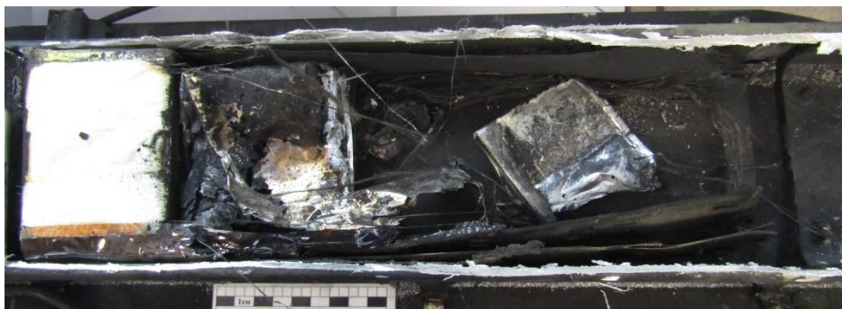
Рис. 7. Поврежденные аккумуляторные батареи
