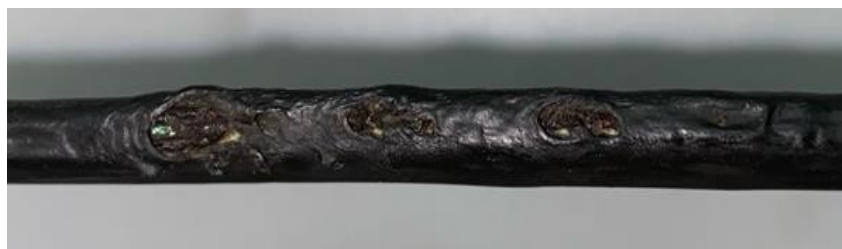
Рис. 4. Электропроводник с признаками термического повреждения
