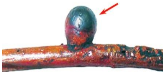
Рис. 2. Крупное вздутие на электропроводнике
